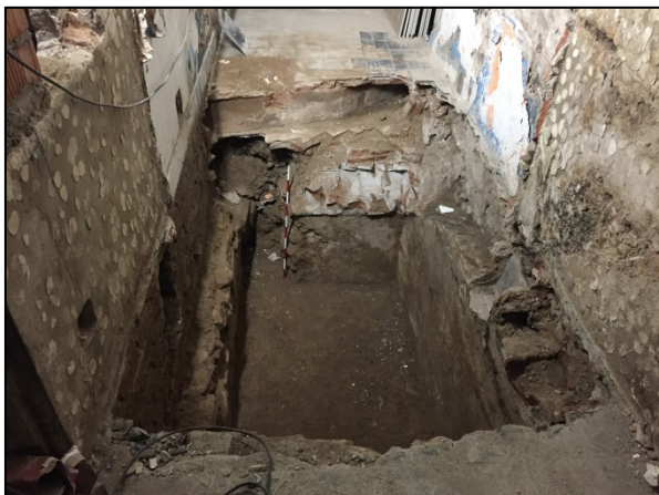
Imatge 12. Fossat d'ascensor. S'observen les parets i part de la coberta de la galeria del soterrani enderrocat. A la dreta la fonamentació del pati de llums que trenca la galeria.
