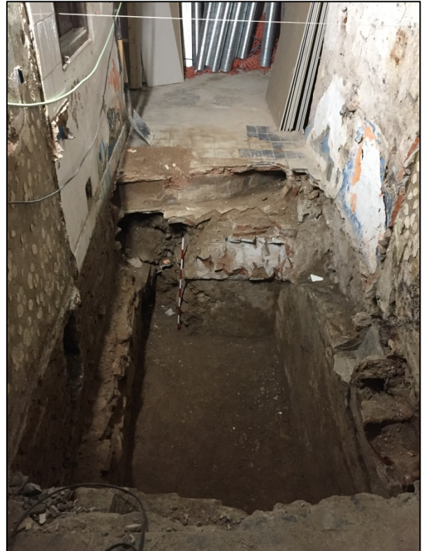
FOTO 53. Fossat d'ascensor. Galeria enrunada i riostra pati llums
