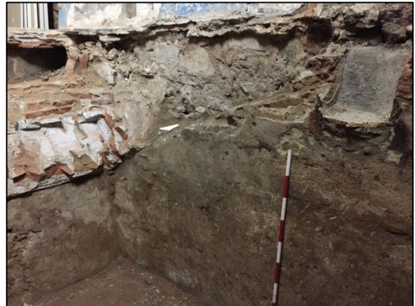
FOTO 55. Fossat ascensor. Detall impronta coberta galeria enrunada
